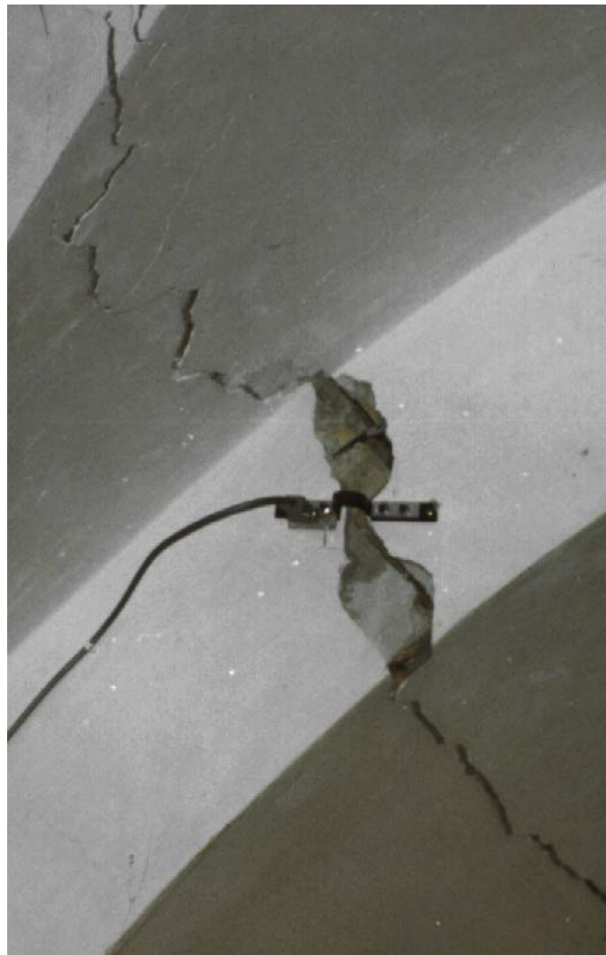
fig.4 -Biffa installata all'interno della cattedrale di Pienza
